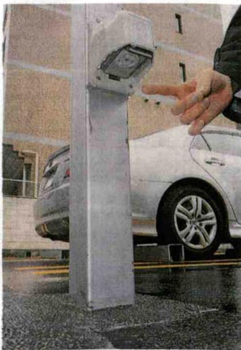
コインパーキングに設置された電気自動車用充電設備。伊丹市西台1
